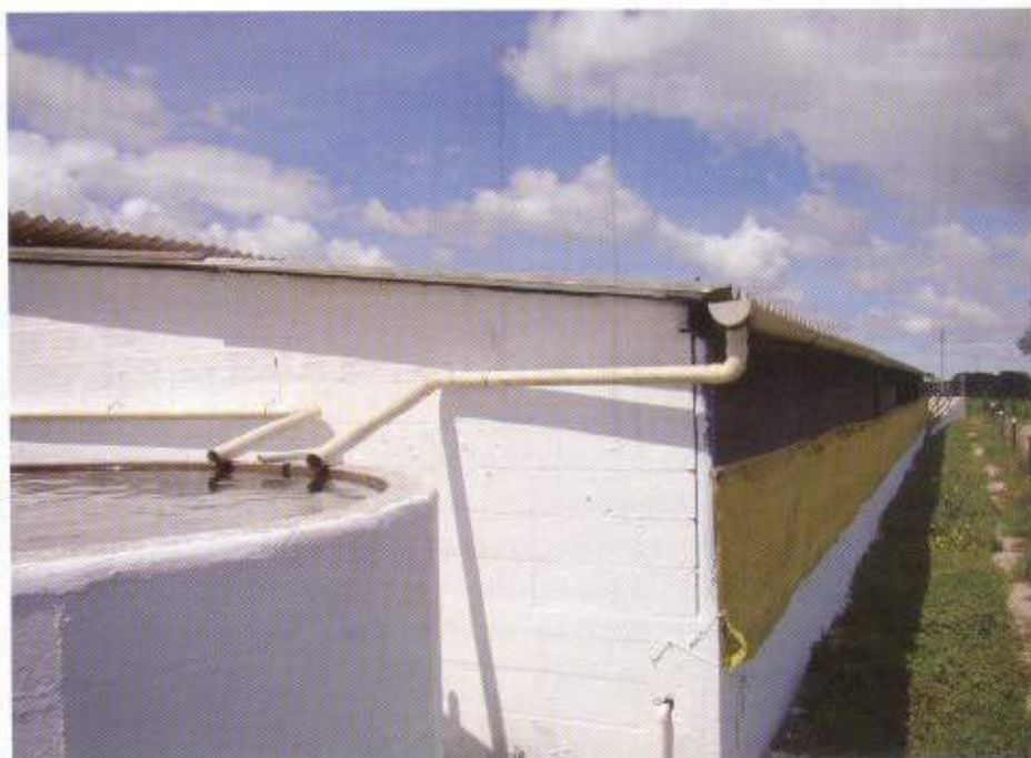
Sistema de recolección de aguas lluvias
