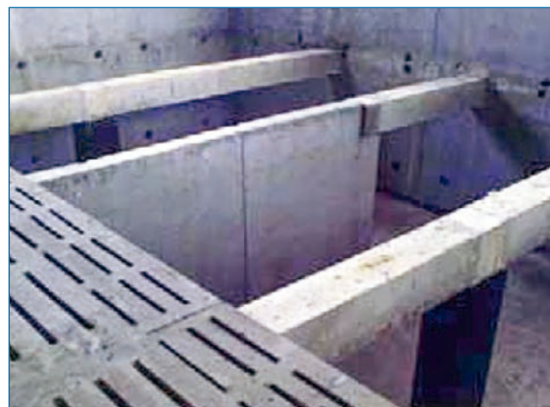
Figura 16. Foso de almacenamiento bajo enrejillado (Institut d'Elevage)
