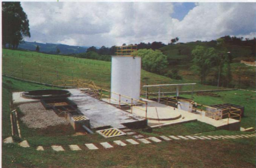
Planta de Tratamiento de Aguas, Derivados Cárnicos San Pedro.
