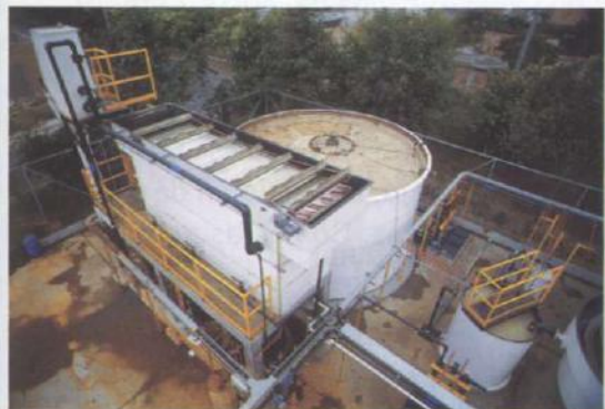
Planta de Tratamiento de Aguas, Funza.
