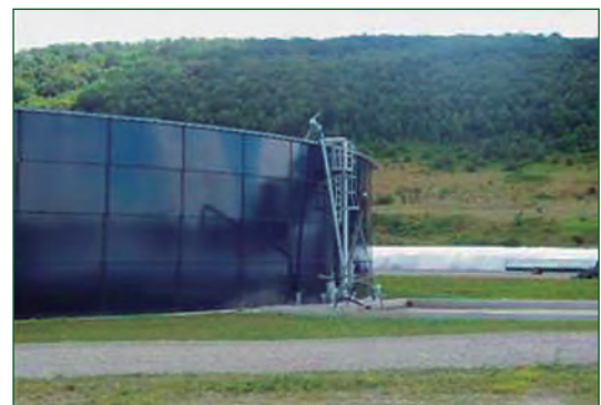
Figura 7. Tanque de almacenamiento de purín sobre el suelo
