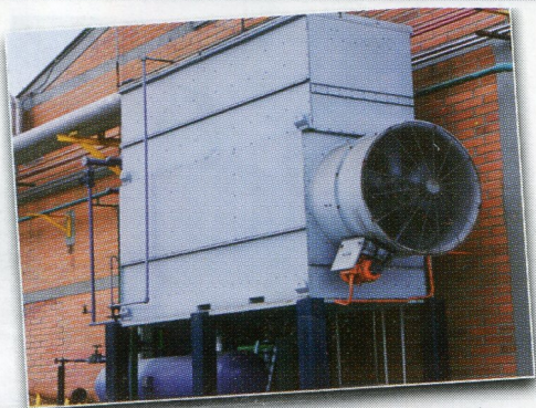
Generación de Frío. Condensador Evaporativo Planta Procesadora San Pedro
