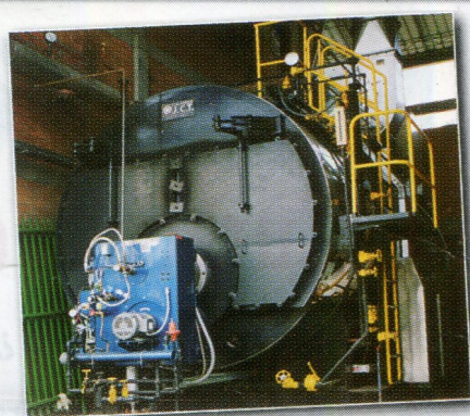
Generación de Vapor. Caldera 600 BHP Planta Procesadora San Pedro
