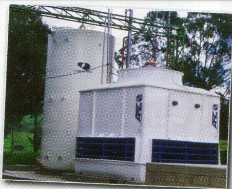
Generación de Frío. Torre de enfriamiento Planta Pulverizadora San Pedro
