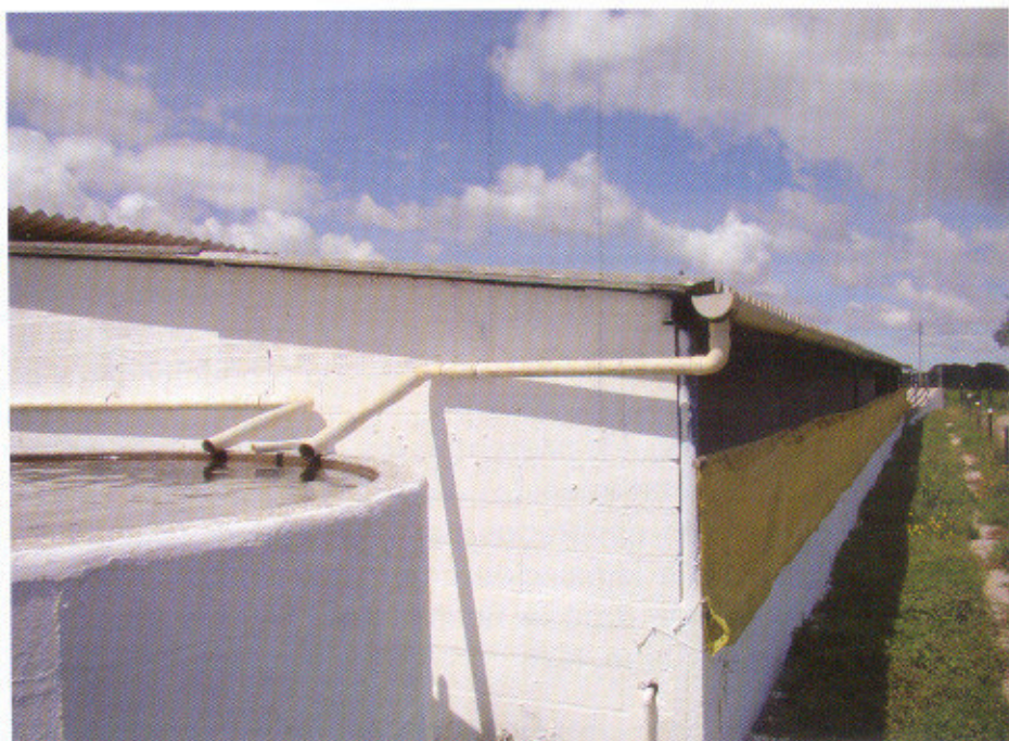
Sistema de recolección de aguas lluvias
